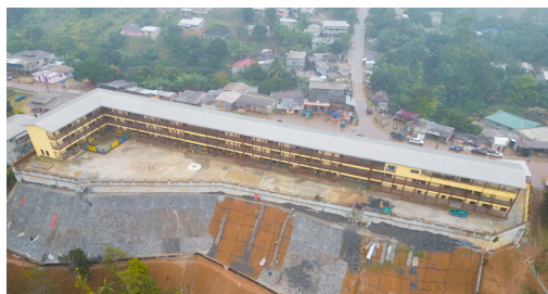
ÉCOLE PRIMAIRE DE MONTALIER TRANSFO
